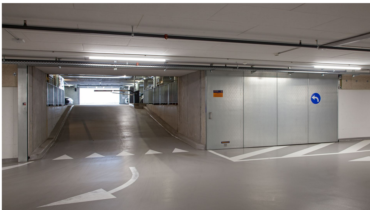
Brandschutzschiebetor In Tiefgarage als Feuerschutzabschluss.
