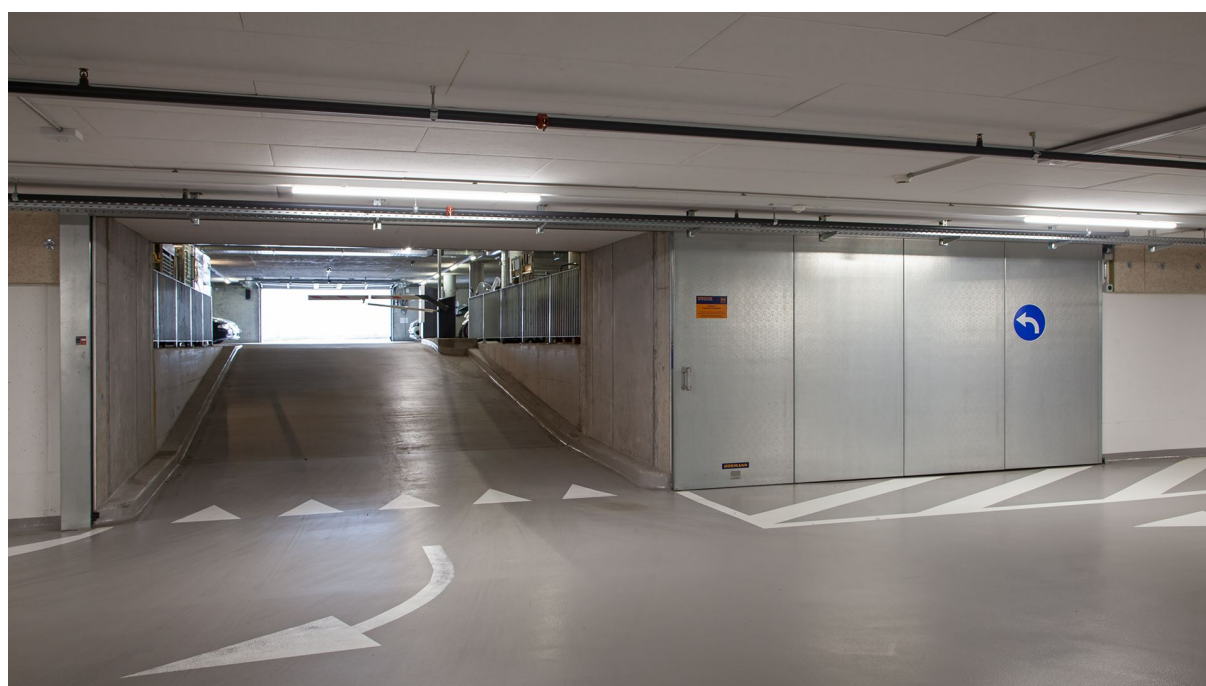
Brandschutzschiebetor In Tiefgarage als Feuerschutzabschluss.
