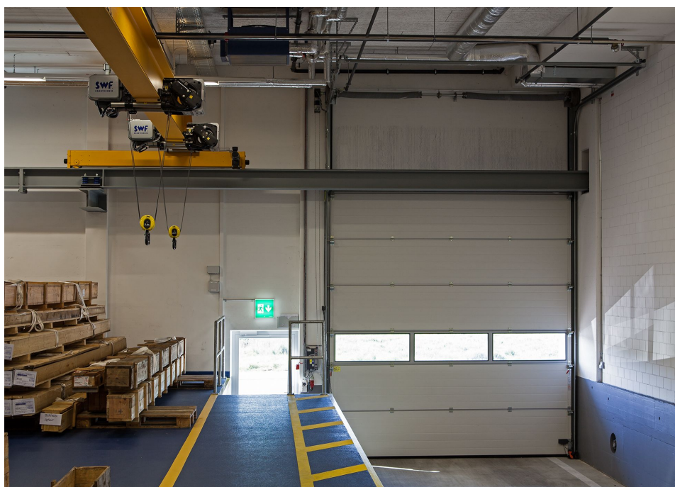
Industrie-Sectionaltor Innenansicht bei Anlieferung
